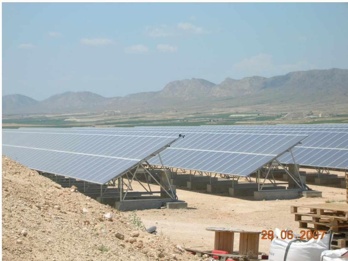
Σχήμα 3.4 Πεδίο ΦΒ συλλεκτών σε ΦΒ σταθμό
