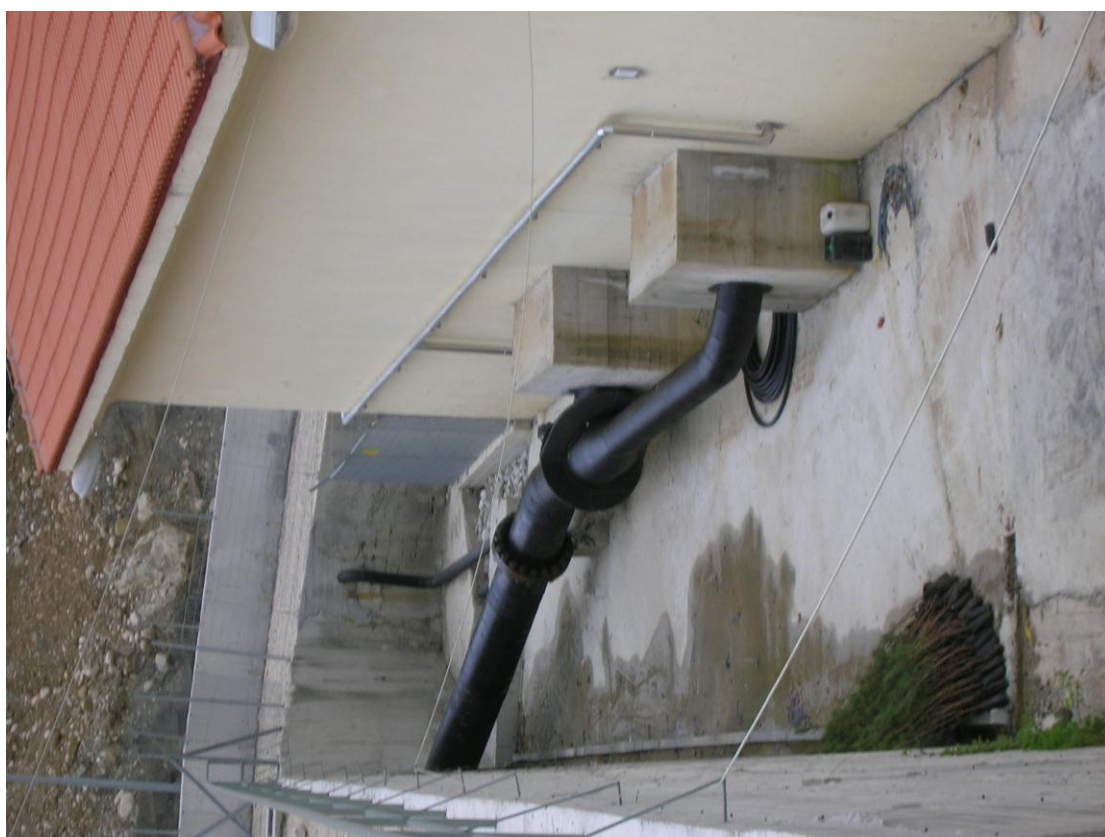
Σχήμα 7.7 Ο μηχανισμός ελέγχου και ο αγωγός πτώσης πριν την είσοδό του στο κτίριο των στροβίλων ενός μικρού Υ/Η.
