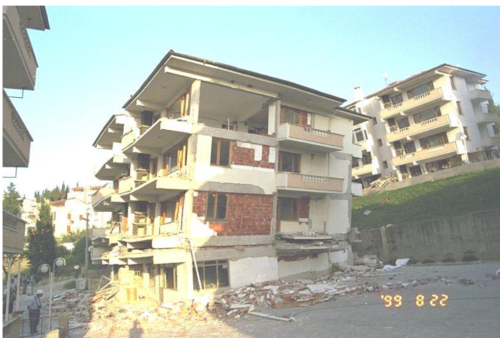
Σχήμα 2.43. Αστοχία 2ου ορόφου (μαλακός όροφος) (Σεισμός Kocaeli M=7.4, Turkey 17/08/1999, φωτογραφία από Earthquake Image Information System, NISEE, University of California, Berkeley)
