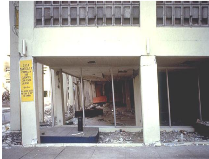
Σχήμα 2.40. Αστοχία μαλακού ορόφου
