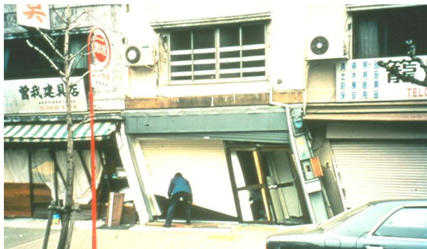
Σχήμα 2.42. Αστοχία μαλακού ορόφου σε ισόγειο (Σεισμός Kobe M=7.2, Japan 17/01/1995)
