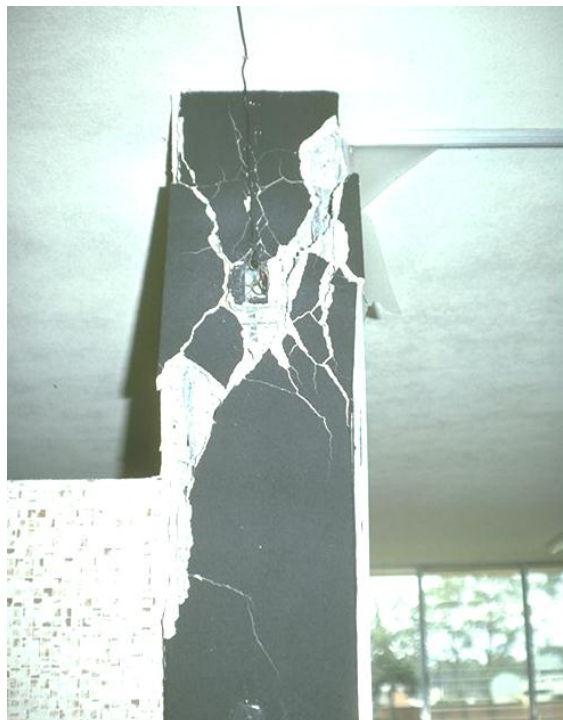
Σχήμα 2.47. Αστοχία κοντού υποστυλώματος λόγω του μη φέροντος τοιχείου (Σεισμός Gualan M=7.5, Guatemala, 04/02/1976, φωτογραφία του K.V. Steinbrugge,
