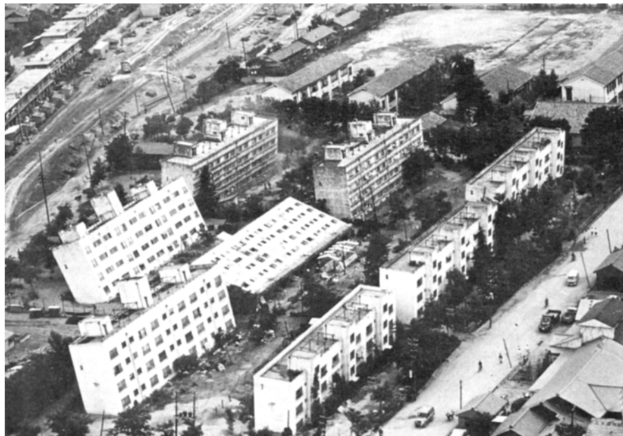
Εικόνα 8-1 Καταστροφή οικοδομών εξαιτίας της ρευστοποίησης του υποβάθρου θεμελίωσης κατά τη διάρκεια σεισμού. Οι οικοδομές δεν υπέστησαν ζημιές αλλά έγειραν άθικτες. (Φωτο. G. Housner, California Institute of Technology)
