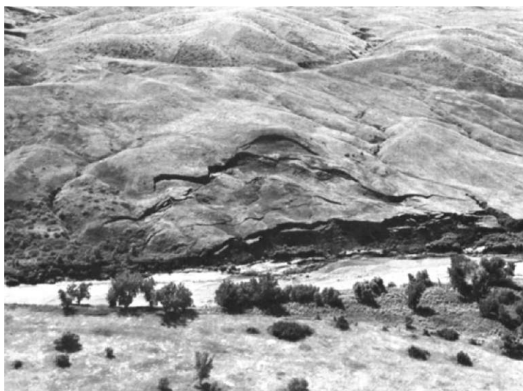
Επικείμενη κατολίσθηση του επιφανειακού χαλαρού μανδύα πάνω στο βραχώδες υπόβαθρο. Αιτία είναι η υποσκαφή του πόδα του πρανούς λόγω διάβρωσης. Στην κεφαλή της ολίσθησης διακρίνεται η χαρακτηριστική αναβαθμίδα.
